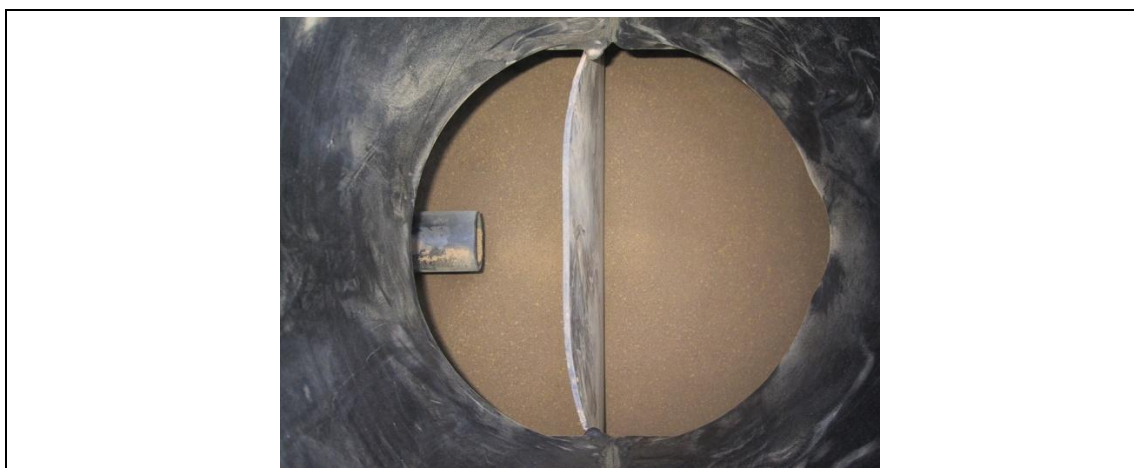
Kuva 4. Suodatin täytettynä tasaisesti fosforinpoistomassalla.
