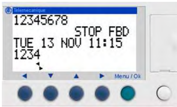
Kuva 6. Zelio -ohjausrele Biokem panospuhdistamossa STOP -tilassa.
