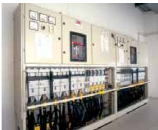
Kiskoilla ja laitteilla varustettu kojeisto, joka perustuu Kabeldon-IP-järjestelmään.
