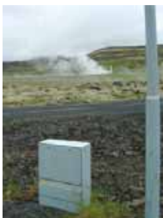
Kabeldon-kaapelijakokaappi Islannin lounaisosan kuumilla lähteillä, joista kuuma vesi ohjataan putkia pitkin Reykjavikiin.
