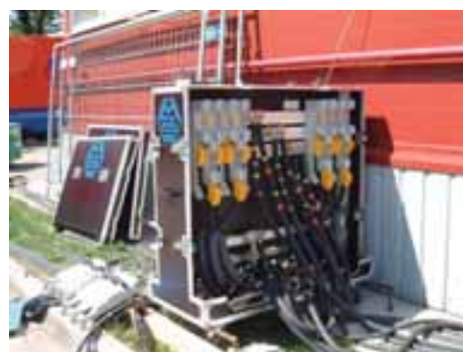
Latvian Riiassa vuonna 2003 järjestettyjen Euroviisujen tilapäiset jakokeskukset, joiden yhteydessä käytettiin kytkinlaitetta SLB 2 ja 1600 A:n kiskoja.
