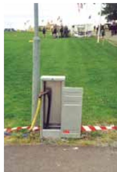
Ruotsin Jönköpingissä olevan messualueen vesihuoltoa varten käytetään CDC-jakokaappia.
