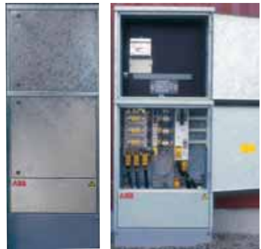
Kaapelijakokaappi, johon on asennettu kWh-mittari.
