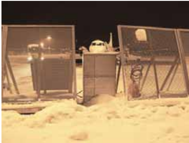
Ruotsissa Tukholman Bromman lentokentällä oleva jakokeskus, joka jakaa virtaa maassa oleviin lentokoneisiin muun muassa tankkausta ja huoltoa varten.
