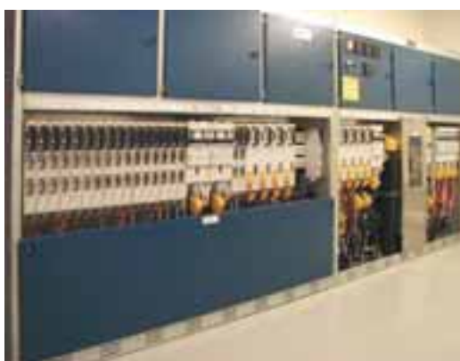
EMF-kojeisto, jossa on Kabeldonin kiskoja ja laitteita.
