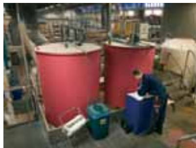
Pintakäsittelyn jäteveden puhdistuslaitos
