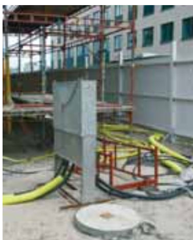
Kaapelijakokaappi päävirran jakamiseen Ruotsissa Malmön Dockanin-sataman rakennusalueella
