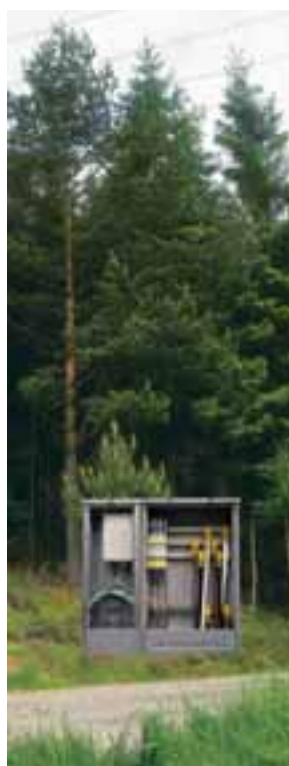
Jakokaappeja sähkö- ja valokuituverkkoa varten
