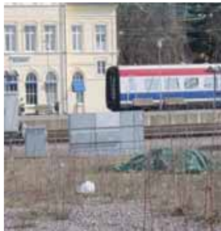
Rautatien sähköisten signaalilaitteiden kaapelijakokaapit Ruotsissa Kalmarissa
