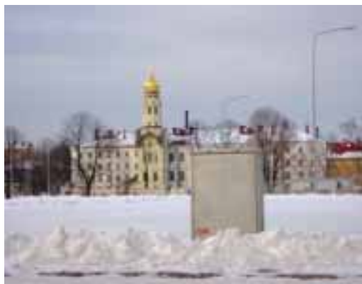
CDC-kaappi valaistuskeskuksena Liettuan Riassa
