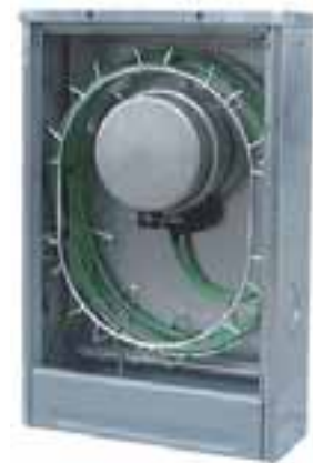
Jakokaappi, jossa on valokuitukaapelin keräteline.
