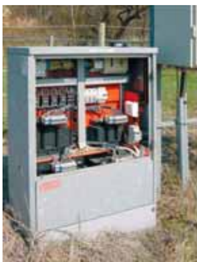
Ruotsissa sijaitseva kaapelijakokaappi, joka jakaa virtaa E22-tien kiertoliittymän valaistuksen ohjauslaitteille. Ne on valmistanut Vägfors.
