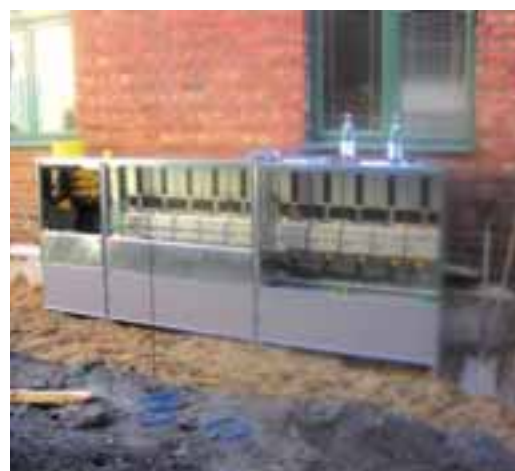
Uusia pienjännitekojeita kulttuurisesti arvokkaan rakennuksen kunnostustyömaalla Uddevallan vanhalla kauppatorilla Ruotsissa
