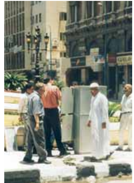
Katuvalaistuksen kaapelijakokaappi Egyptin Aleksandriassa
