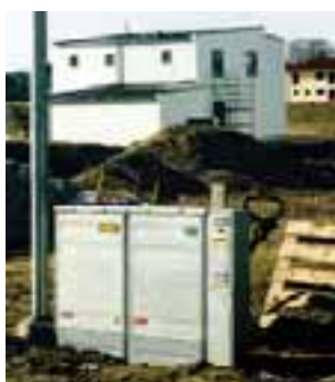
Sähköhuollon ja kaapelitelevision kaapelijakokaappi uudella asuinalueella Ångelholmissa, Ruotsissa
