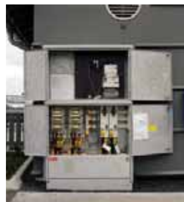
McDonald's käyttää kaikkialla Ruotsissa yhdenmukaisia sähkönjakelukeskuksia. Kuvassa näkyy Vårgården McDonald'sin keskus.
