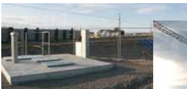
Kaapelijakokaappi Ruotsissa Hallandsåsenin läpi kulkevan kaksiraiteisen rautatien rakennustyömaalla
