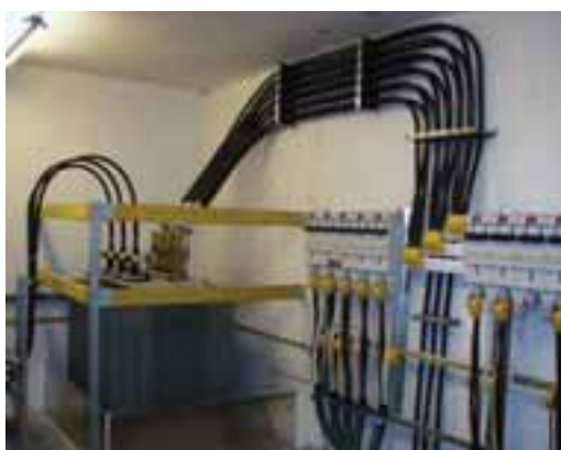
Esimerkki ABB Kabeldonin pienjännitetuotteista, jotka on asennettu seinään. Kuva on Norjan Trondheimissa olevasta muuntamosta. Seinään asennettavien tuotteiden materiaali-, hinta- ja toimitustiedot: ABB Oy, Kotimaan tuotemyynti
