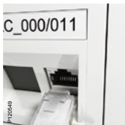
P120549 Liittimet käännetty johtojen irrottamisen helpottamiseksi.
