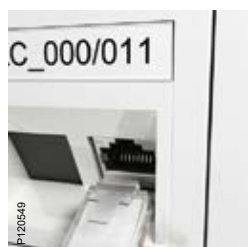
Liittimet käännetty johtojen irrottamisen helpottamiseksi.
