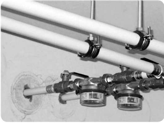
WehoPress-komposiittiputket ja huoneistokohtaiset kylmän- ja lämpimän käyttöveden vesimittarit.
