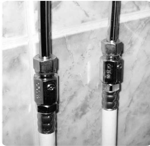
WehoPress-käyttöveden kytkentäjohtojen kalustekohtaiset sulkuventtiilit.
