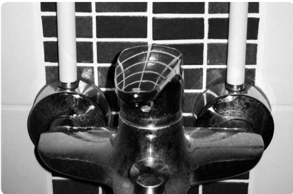
Pinta-asennetut WehoPress-kytkentäjohtot suihkuhanalle.
