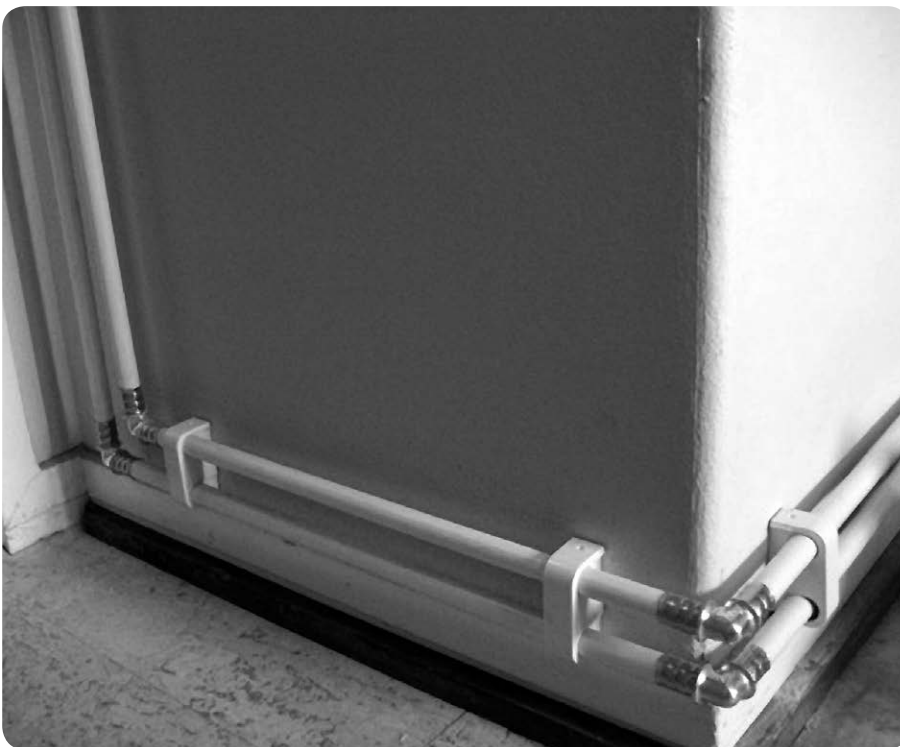
Näkyville jäävien WehoPress-lämmitysputkien kannakointi.
