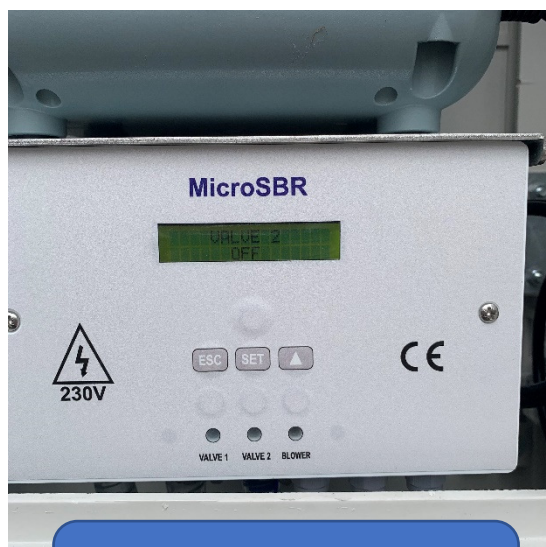
Vārsts 2 Notekūdeņu izsūkņēšana - sūknis ZILA
