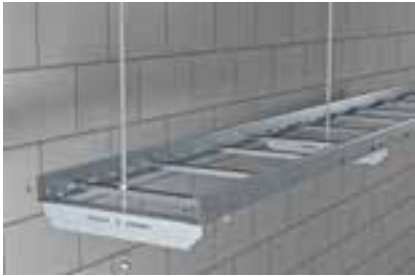
MAHU Keskikannake Ø13 reikä kierretangolle. Tikashylly kiinnitetään keskikannakkeeseen LKS 40 kiinnityskappaleella. Kaapelikuorma jaettava tasaisesti.
