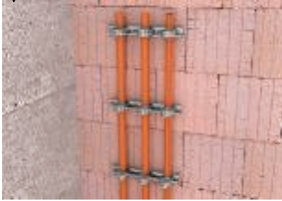
Senkrechte Montage der Kabel mit Bügelschellen an der Wand
