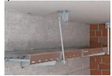
Deckenbefestigung der Gewindestangen mit Brandschutzbügel
