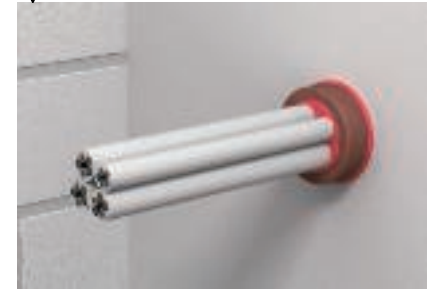
Vollbelegung der Rohrschale
