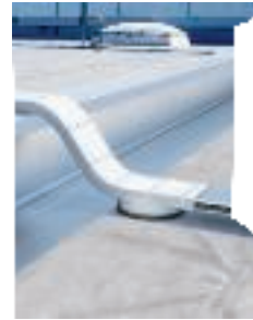
Einsatz bei über Brandwand geführten Photovoltaikleitungen
