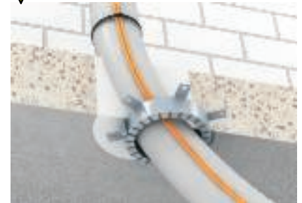
Rohrpostanlagen mit 2 Begleitleitungen
