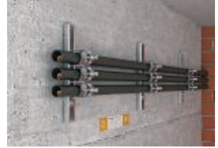
Platzsparende Installation mehrerer Rohre nebeneinander mit Bügelschellen
