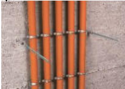
Befestigungspunkte neben den Kabeln direkt an der Wand
