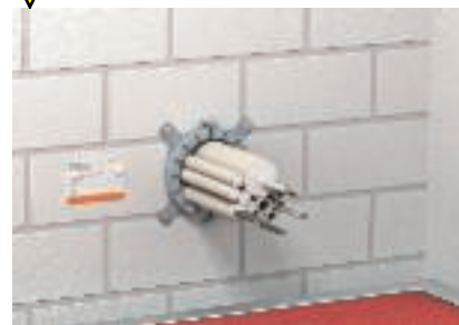
Gekennzeichnete Abschottung von Installationsrohrbündeln
