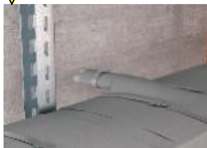
Kabelausgang mit Bandagierung
