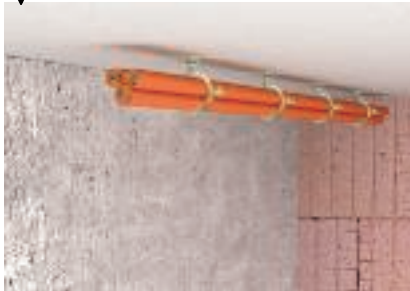
Gebündelte Kabelverlegung unter der Decke
