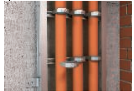
Kabelinstallation mit Bügelschellen an den Sprossen der Steigeleiter
