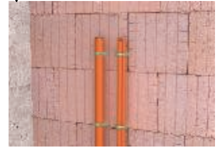
Senkrechte Kabelinstallation als Einzel- und Bündelverlegung an der Wand
